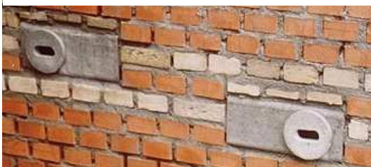
Nistkästen an der Außenwand (oben) und eingemauerte Niststeine (unten). Nisthilfen sind schon ab 20 Euro pro Stück erhältlich.
